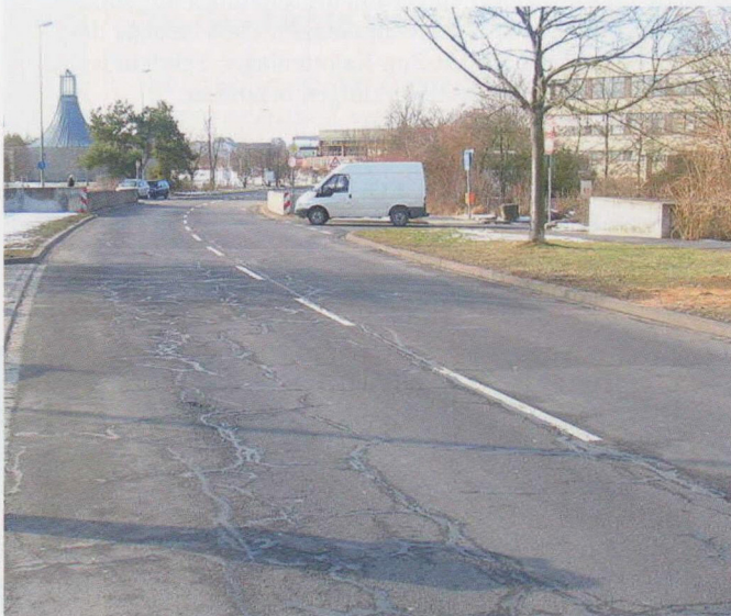
Bild 1. Rissbild der Straße
