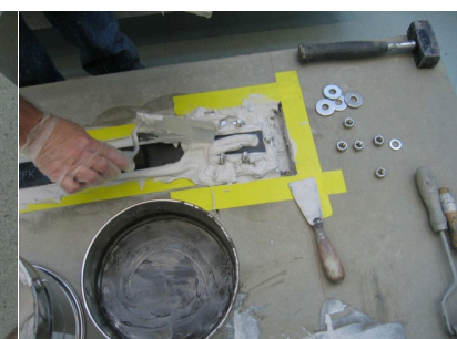
Die Lamelle wird fachgerecht verklebt. Die Endbereiche werden mit Klebstoff beschichtet. Die Abstandhalter werden unter bzw. auf die Lamelle gelegt
